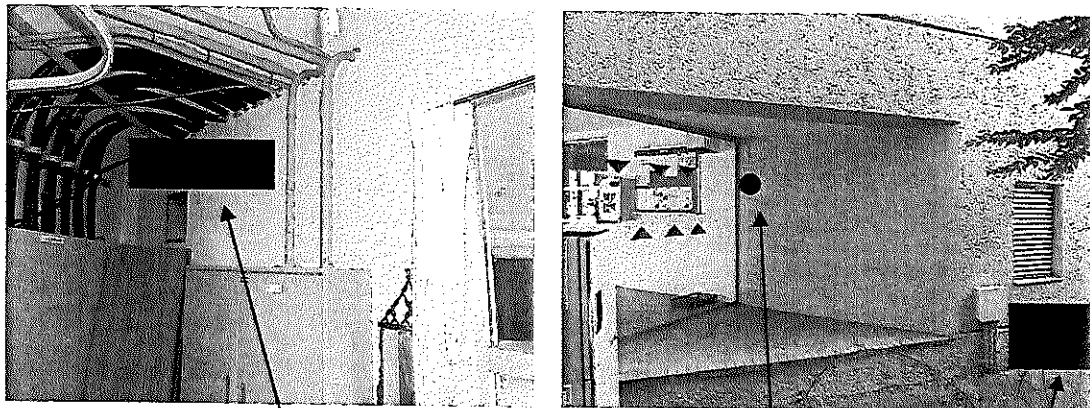
管理事務所 室内機設置予定箇所
