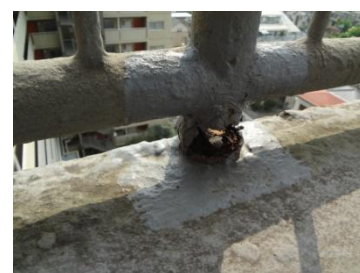
↑鉄骨階段 手すりの根元が腐食しているところもあります
