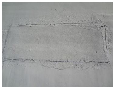
↑屋上防水層の劣化が目立つようになりました
