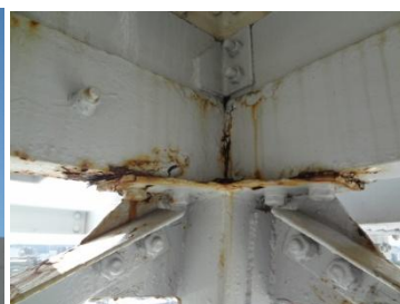
↑高架水槽の架台に錆が発生しています
