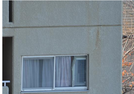
A棟 壁の亀裂
